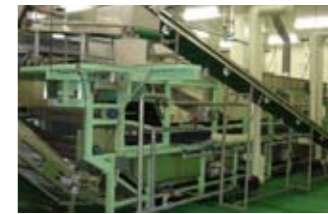
●2段階殺菌冷却槽
